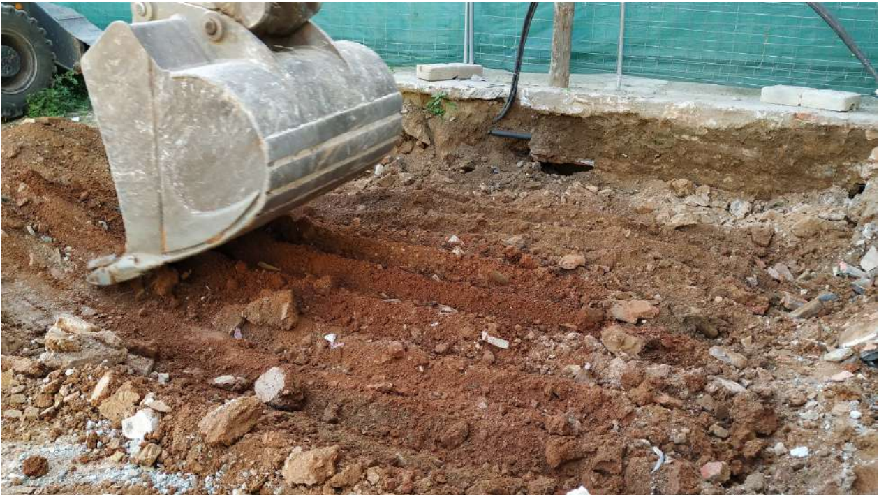
5.- Vista de les tasques de retirada dels nivells de rebliment UE 102 i UE 103.
