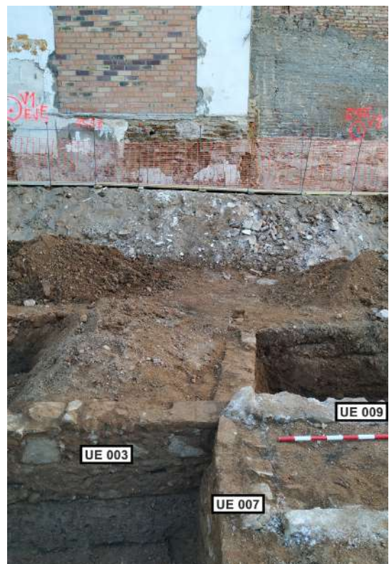
9.- Primer pla de la paret mitgera UE 007, tancament UE 003 (esquerra) i l'estructura UE 005 (fons).
