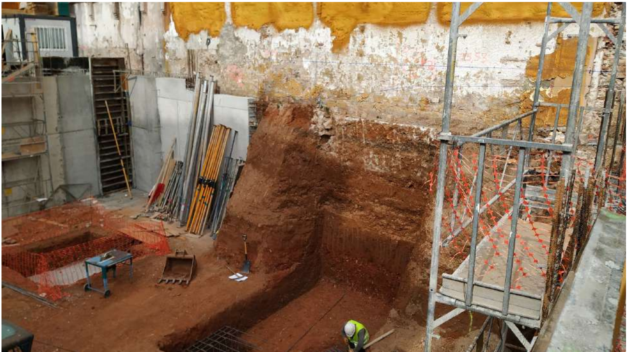
21.- Vista del procés de construcció del tancament perimetral per trams paral·lel a la paret mitgera entre la nova edificació i la finca núm. 16.
